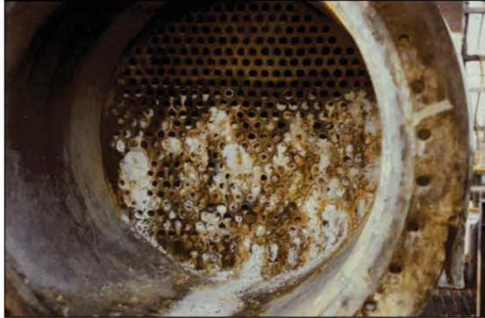
Abbildung 12 Blick auf den Rohrboden eines beschädigten Kondensators.
