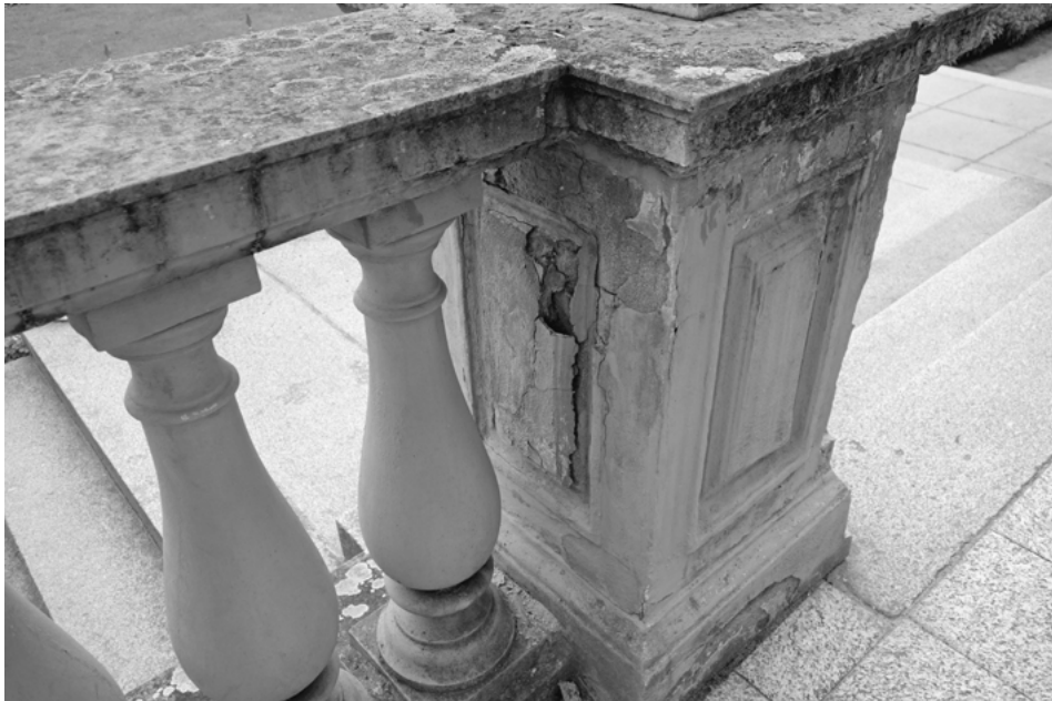
2 Fortgeschrittene Schäden in Branitz. Frühzeitige Detektionsverfahren für vorausschauende Maßnahmen im Rahmen eines Erhaltungsmanagements: (G1) (G3) (G4) (G5) (M1) (M3) (M7) (H2) (H3) (P2) (C9).
