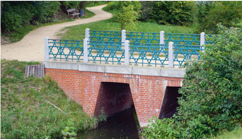
VIII Branitz: Mauerwerkbrücke: Verfärbungen nur durch undichte Fugen oder durch eine untüchtige Abdichtung? (G3) (G4) (G5) (M1) (H2).
